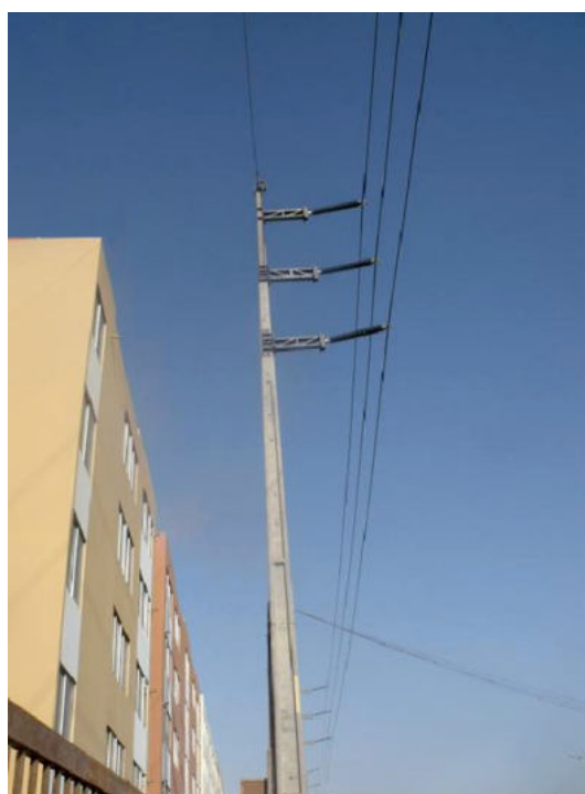
Figura 3. Línea de subtransmisión, 66 KV.
