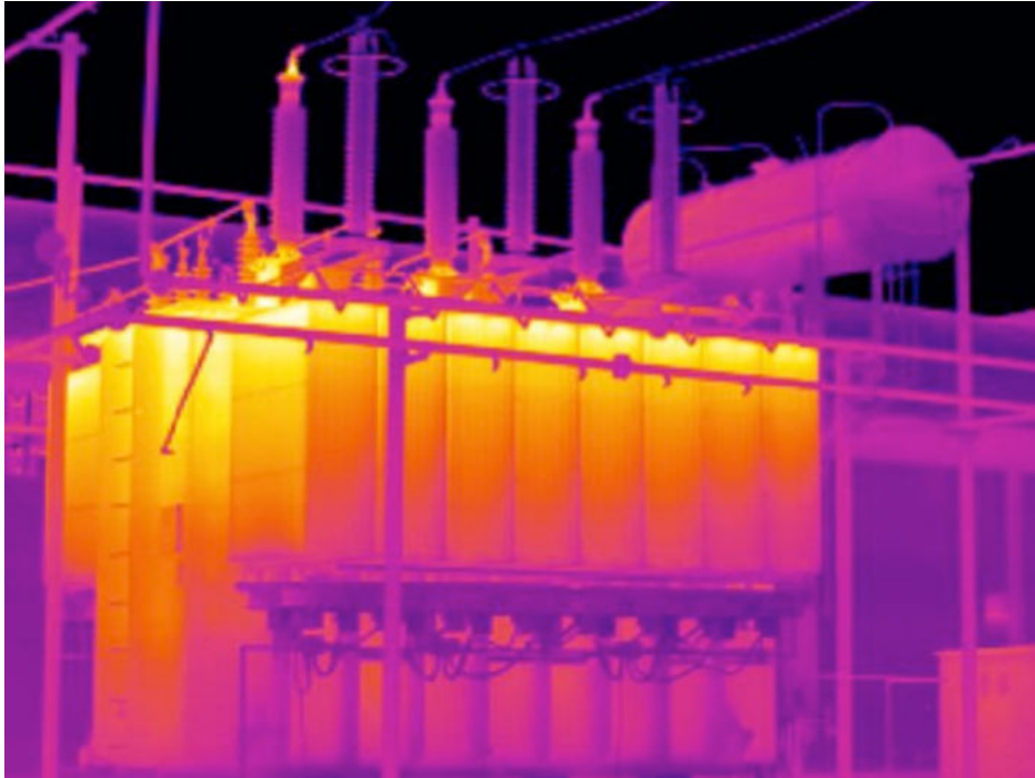
Figura 4. Detección de puntos calientes en un transformador usando IRT.
