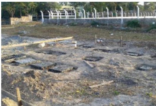
Figura 6. Vista de los grupos de pilotes de lo campo experimental de la UFC.
